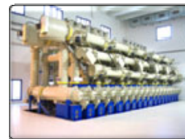
Postes électriques isolés au gaz
