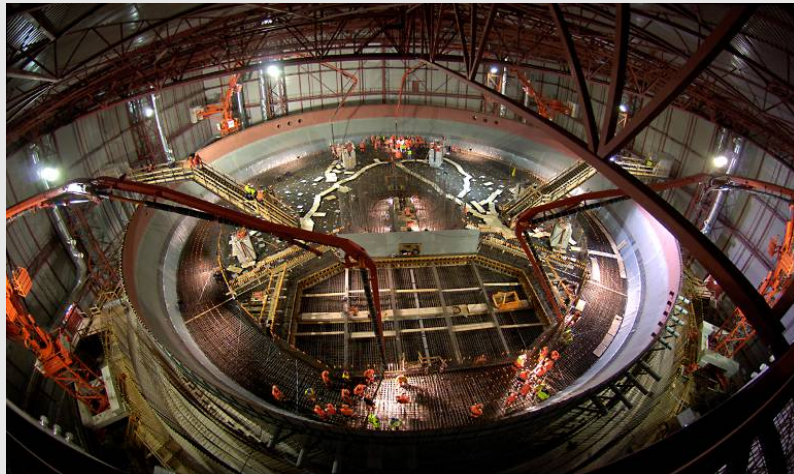
Près de 2000m 3 de béton ont été coulés. L'épaisseur finale de cette dalle est maintenant de 1.5m.
