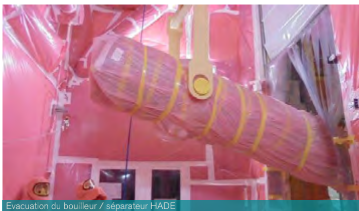
Evacuation du bouilleur / séparateur HADE
