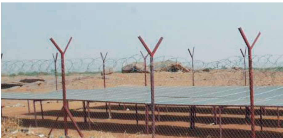
Panneau solaire alimentant le puit COMI23
