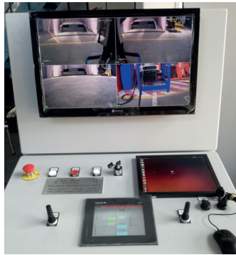
Contrôle commande du système RODSY30
