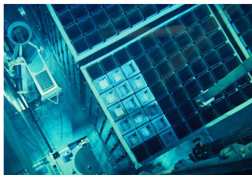
Piscine de refroidissement (EDF Belleville)
