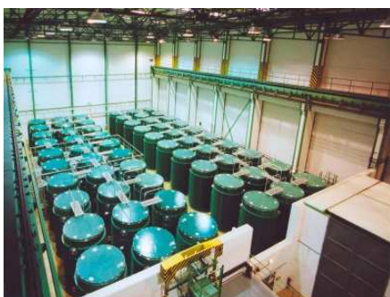
Figure 53 : Entreposage en emballages CASTOR® sur le site de la centrale de Dukovany (Rép. Tchèque)
