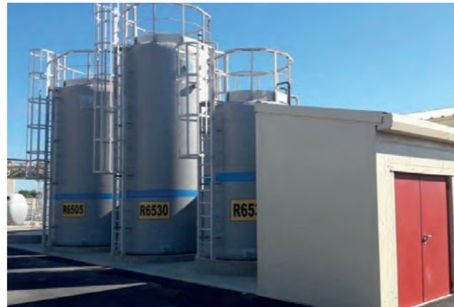
Atelier de préparation de l'eau industrielle
