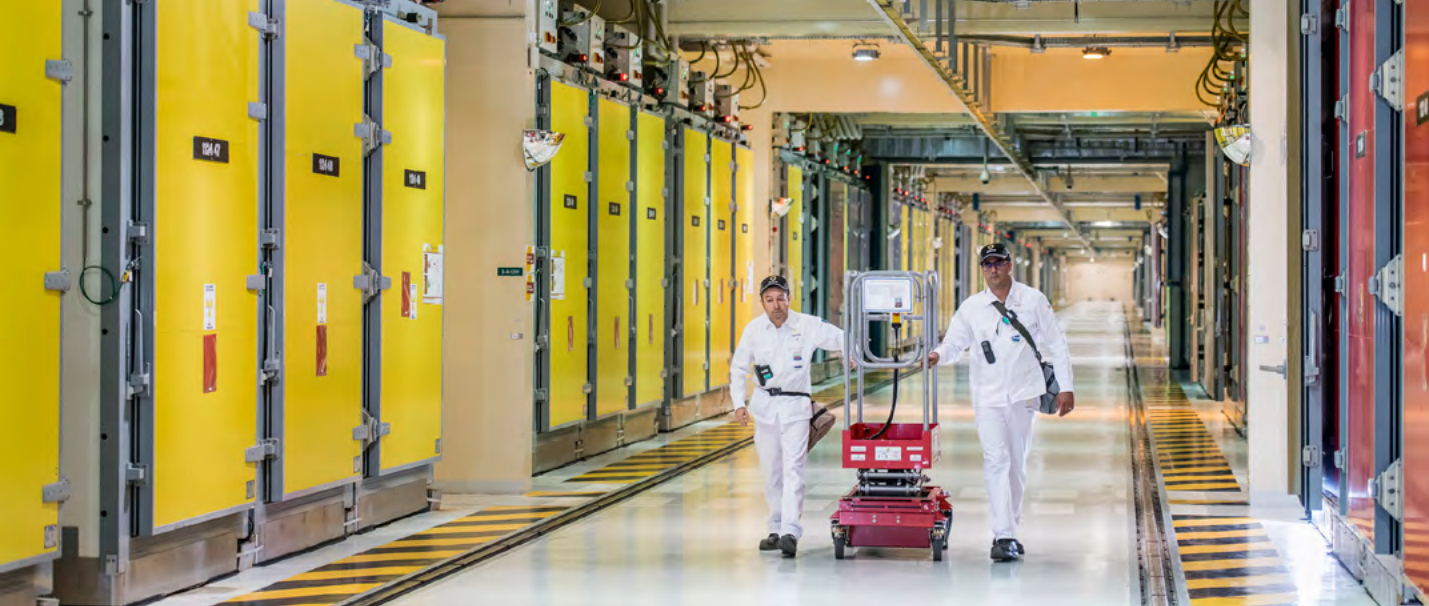
Opérateurs dans un hall station de l'usine Georges Besse 2. Stations portes rouges où l'on récupère les cylindres remplis d'uranium enrichi ; stations avec portes jaunes où l'on récupère les cylindres contenant de l'uranium appauvri.
